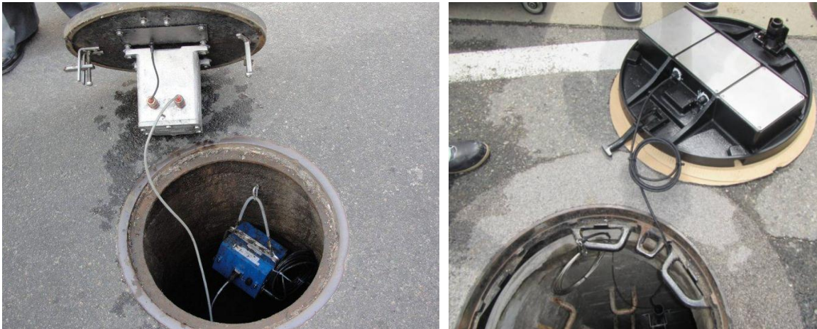
Izquierda: Tapa de cámara con sensores en NY, EEUU. Derecha: Tapa japonesa con tecnología Fujitsu para detectar inundaciones. Ambas con baterías.
