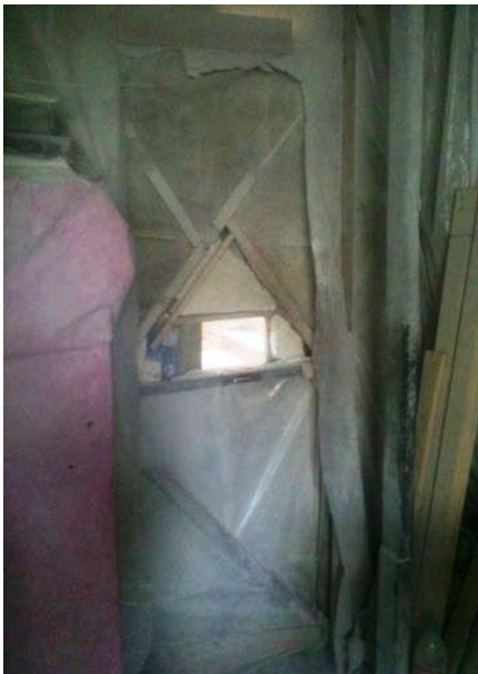
Ilustración 3. Puerta de acceso a una marmolería. Se usó pedazos de alfombra para sellar filtraciones de polvo hacia fuera del taller.
